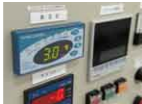
■管状炉が正常に作動しているか制御盤のプログラムと出力を調節
